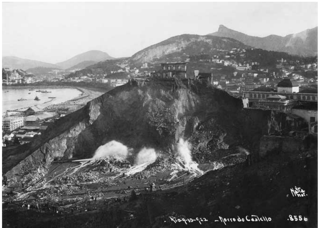
Pode ser visto que praticamente a metade do morro já foi derrubada.
